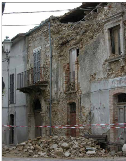
Fig. 5b - Edificio in muratura (classe di vulnerabilità A), con grado di danno 4.
