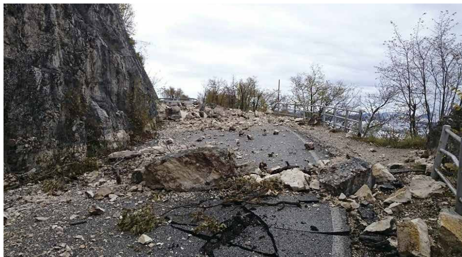
Fig. 5 - Frana Strada Castelluccio di Norcia, Umbria.
