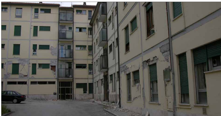
Fig. 5a - Edificio in cemento armato (classe di vulnerabilità C), con grado di danno 3.
