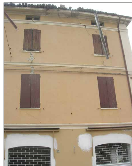
Fig. 5c - Edificio in muratura (classe di vulnerabilità B), con grado di danno 3.
